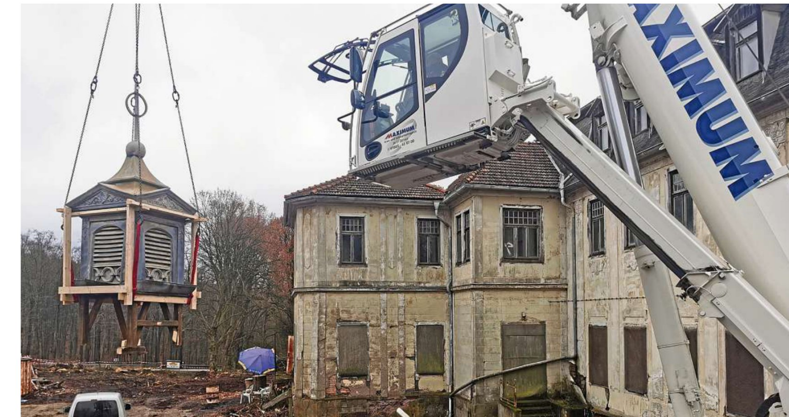
Im Dezember 2020 ist der verzinkte Turm des ehemaligen Jagdschlosses Hohe Sonne abgenommen worden. Weiter wurde bisher nichts zur Sicherung und Sanierung unternommen.
